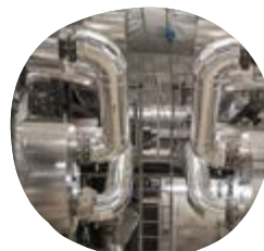
RÉCUPÉRATION DE CHALEUR FATALE
